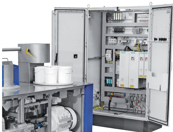
分離型コントロールキャビネット
